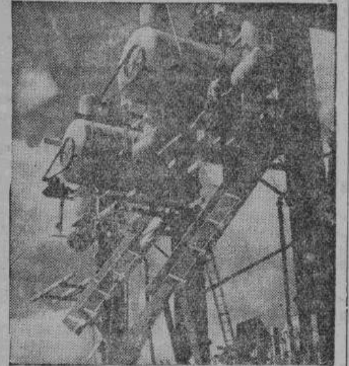
Шахты для извлекаемой земли на одном из строительных пунктов, где работы производятся с помощью сжатого воздуха под поверхностью моря
