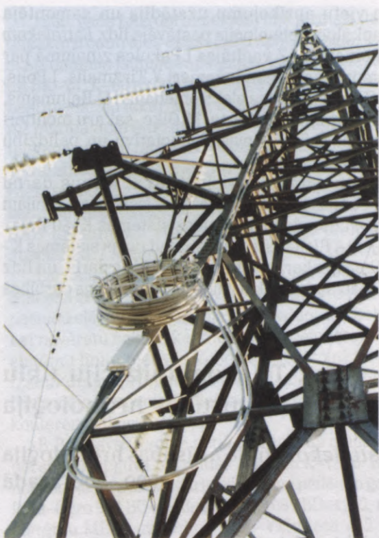
Stikla šķiedras kabeļlīnijas uzmava elektropārraides līnijas stabā
