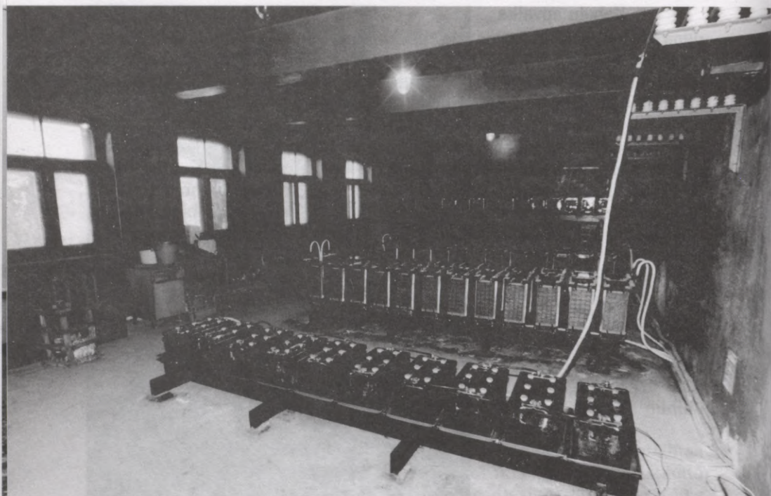
Vecās un jaunās akumulatoru baterijas Kuldīgas centrālē
