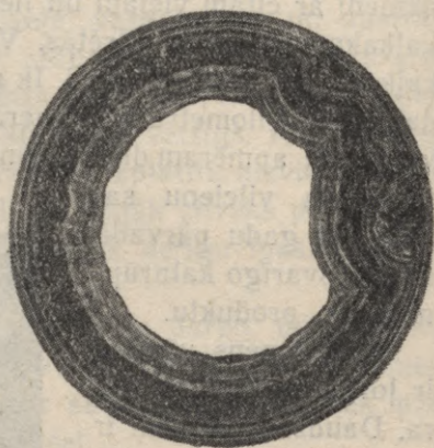
Uz ūdensvada caurules sienām (caurules diametrs 15 cm) piecos gados nogulsņējusies cieta ogļskābā kalcija kārtiņa. Sprūdes karstais avots. Karlovivari. Čehoslovākija.
