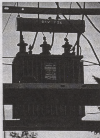
20.1. attēls. Brīvgaisa transformators patērētāju elektroapgādei
