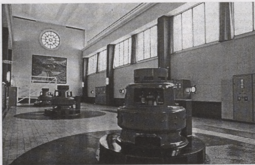
20.11. attēls. Elektrostacijas mašinzāle. Redzami hidroģeneratoru līdzstrāvas ierosinātāji
