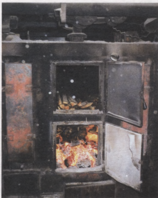
Ūdens sildāmais katls p/u "Vilkme" katlu mājā
