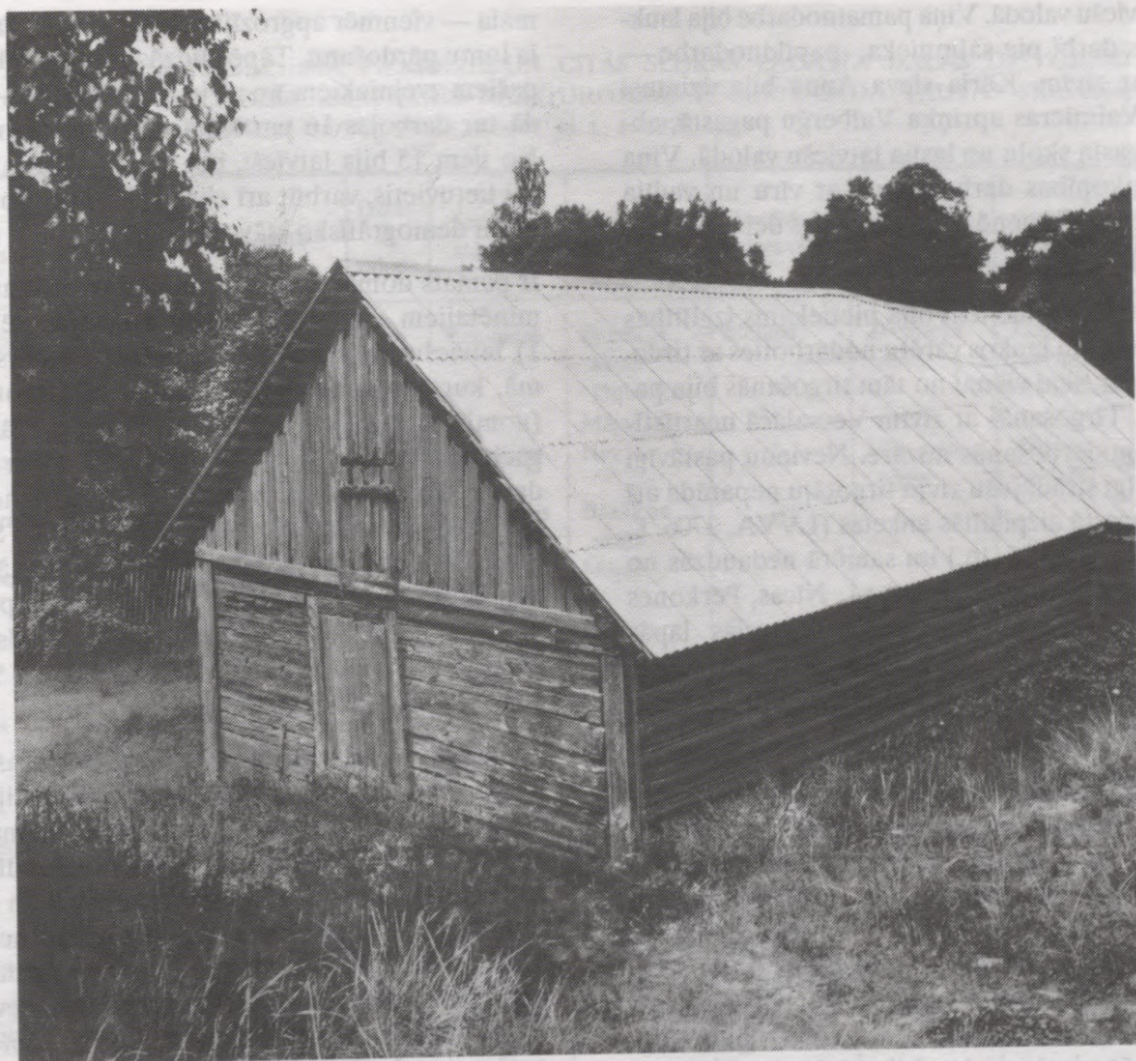
86. att. 1909. gadā balķu guļbūvē statņos celtā brētliņu konservēšanas darbnīca — kūris Talsu raj. Rojas pagasta Melnsila Zivtiņās 1987. gadā. Šifera jumts uzlikts 70. gados (E 1987. gada ekspedīcijas foto).
