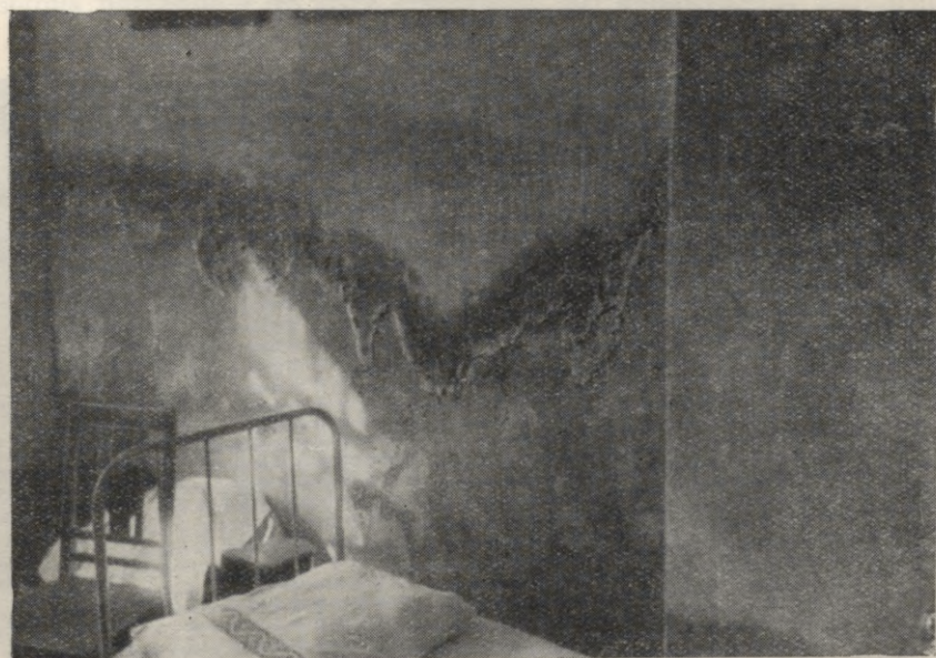
90. att. Hidroģeoloģiskā mitruma iesūkšanās koka starpsienās hidroizolācijas trūkuma dēļ.
