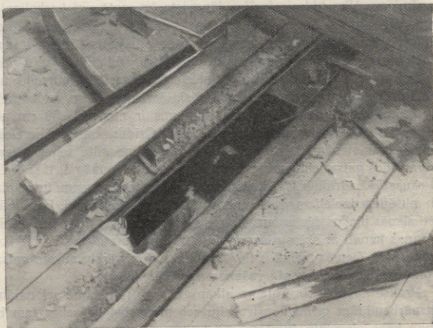
31. att. Aukstā grīda mitras grunts apstākļos: nepareizs atrisinājums — pagrīdē redzams gruntsūdens.
