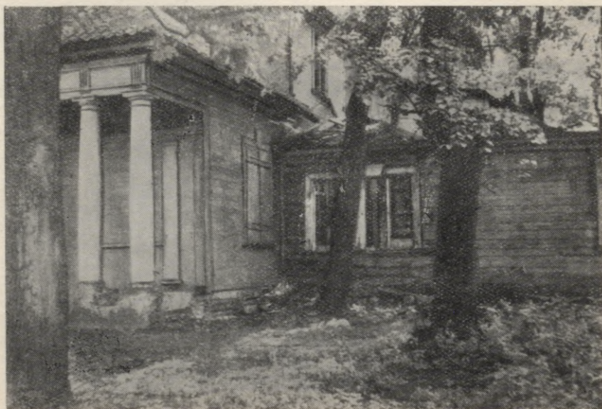
80. att. Bojātā jumta dēļ satrupējusi koka ārsiena.
