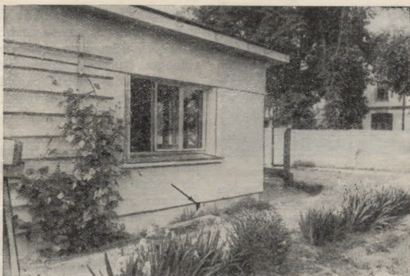
32. att. Aukstās grīdas siltās pagrīdes vēdināšana ar ārējo gaisu caur ailām pamatu cokolā: nepareizs atrisinājums.
