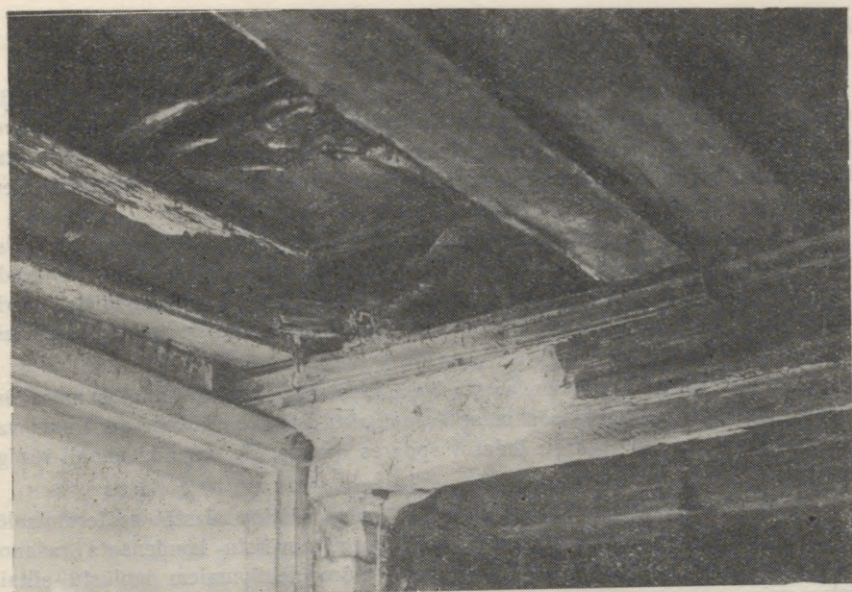
124. att. Mūra ārsienas montāžas mitruma ietekmē satrupējies starpstāvu pārsegums.
