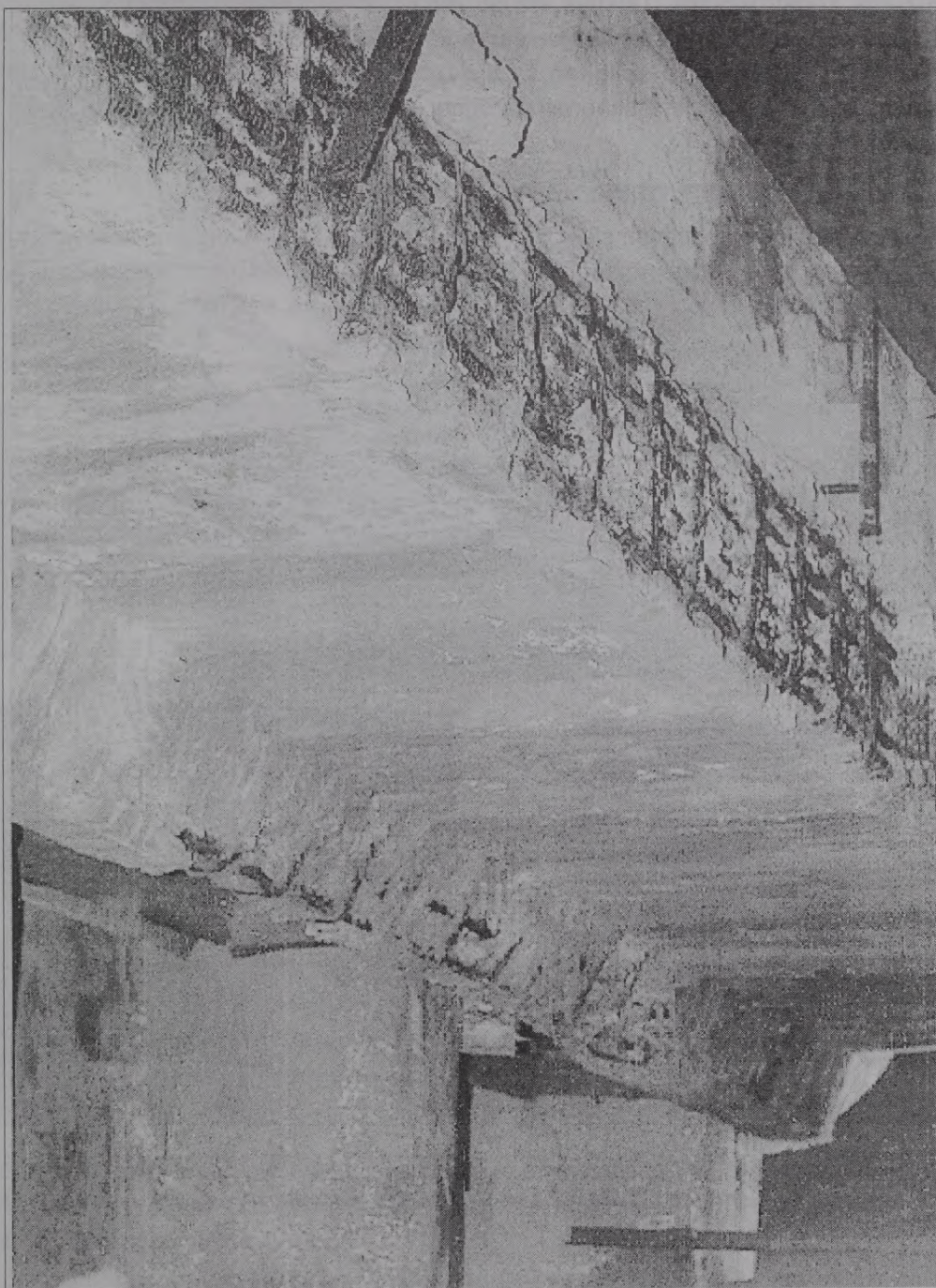
17. attēls. Korodējusi saliekamā dzelzsbetona balstu uzkala (rīgelis).
