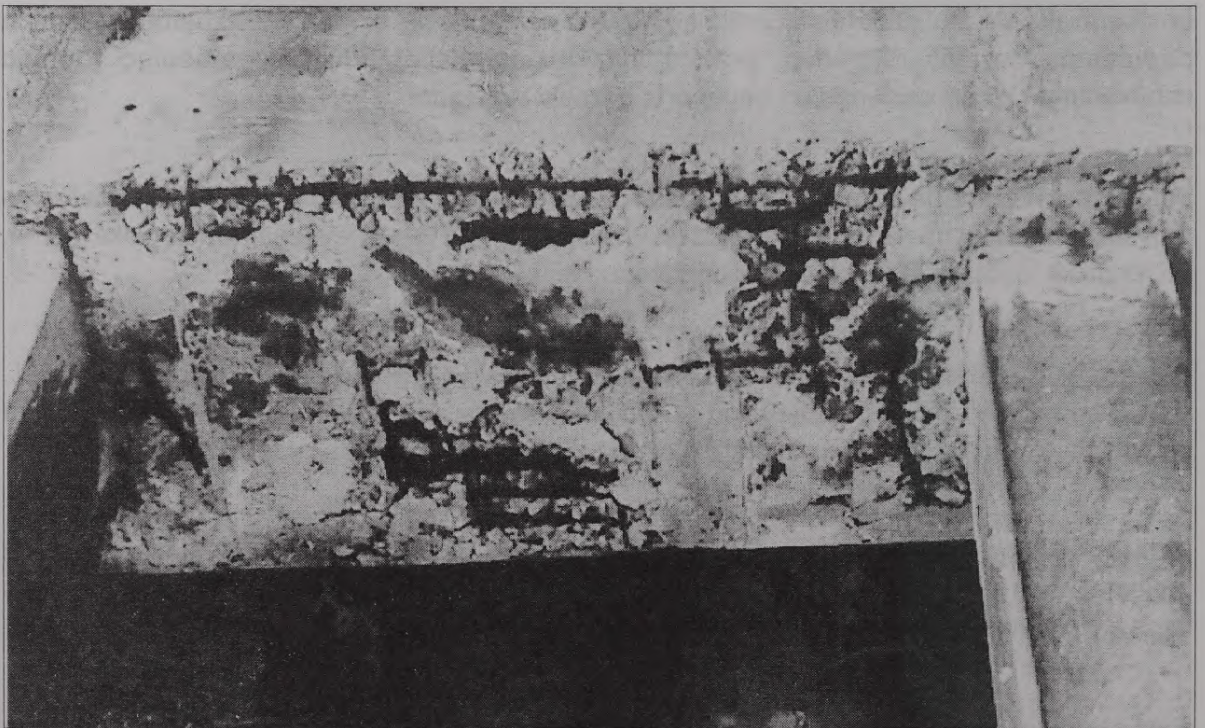
16. a t t ē l s. Ūdens iedarbības rezultātā korodējusi saliekamā dzelzsbetona balsta uzkala (rūgelis).
