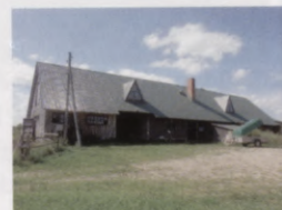
Kalna Bērziņu saimniecības ēka. Dzīvojamā māja sabrukusi padomju laikā. Rikers 1839 Bersing; E 41 bērziņi
