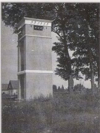
■ Transformatoru punkts Tukumā, Durbes un Mazā Parka ielu stūrī, 1937. gadā
