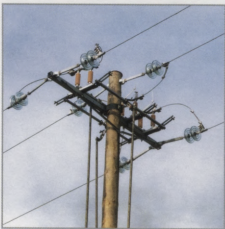
■ 20 kV līnijas atdalītājs vienstatņu starpbalstā
