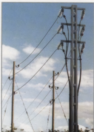
■ Tukuma apakšstacijas 20 kV līniju izvadi
