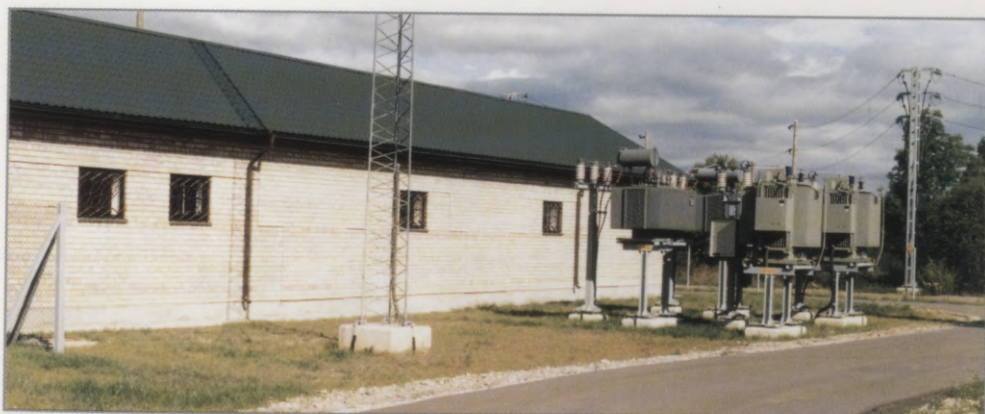
■ Tukuma apakšstacijas 20 kV dzēšspoles, 1999.gadā
