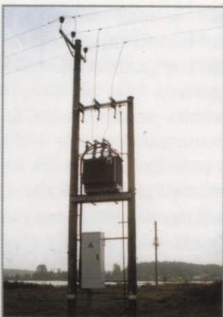
■ Transformatoru punkts "h" veida balstā
