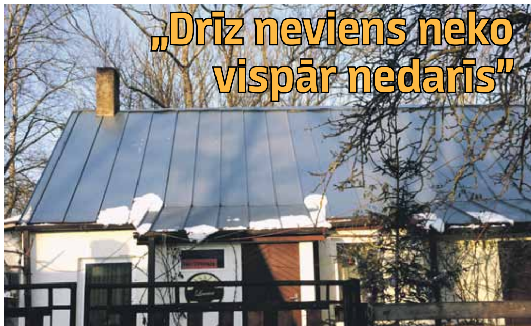
Raiņa ielas 15 saimnieki neuzskata, ka pagaidu skārda jumts būtu kas ārkārtējs Kuldīgas vecpilsētai.
