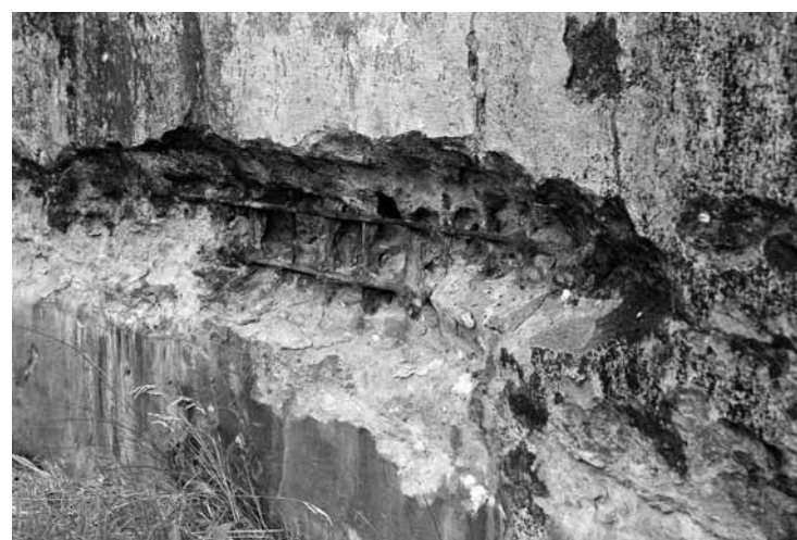
Laika zobs jau papostījis dzelzsbetona būves.
