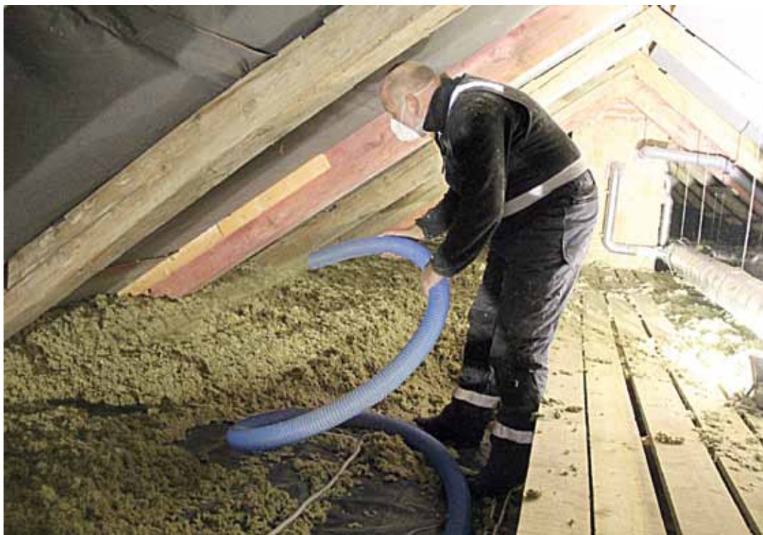
Podkalnu uzņēmums ēkas siltina ar beramo vati, jo tā ir efektīva un process ir ļoti ātrs – līdz 12 kubikmetriem stundā.
