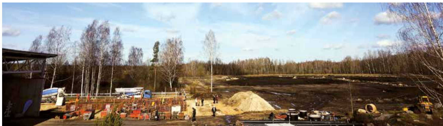
6 hektārus plašajā laukā uzstādīs 1720 saules kolektorus.
