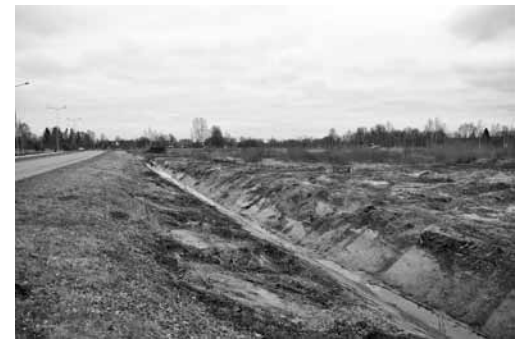
Sūru ielas pļāvās Kuldīgā tiek rakti grāvji, lai nosusinātu mitro vietu, kurā paredzēts bērt grunti no Jelgavas ielas pārbūves. Tur būs arī pagaidu stāvlaukums.
