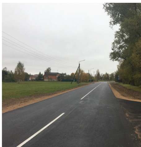
2018. gadā tika īstenots ERAF projekts "Ieguldījums komercdarbības attīstībai Ilūkstes novadā", kura ietvaros tika veikta Strēlnieku ielas posma atjaunošana, lai attīstītu uzņēmējdarbību un uzlabotu piekļuvi ražošanas apbūves teritorijai Ilūkstes pilsētā
