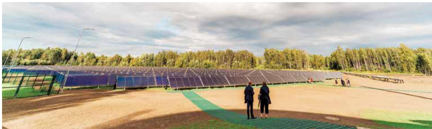
Projekta ietvaros izveidots aktīvais laukums ar 1720 saules kolektoriem, kas, sākot jau ar nākamo apkures sezonu, nodrošinās centralizēto siltumapgādi novada iedzīvotājiem. Foto: Kaspars Suškevičs
