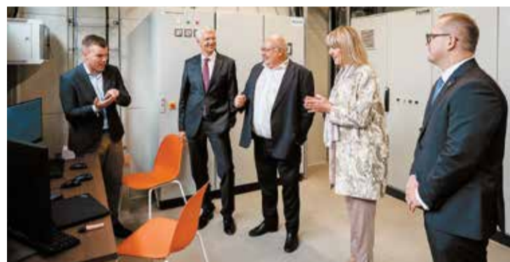
Dāņu uzņēmuma "Arcon-Sunmark" pārstāvji Leo Holms un Martins Pejstrups kopā ar ministru prezidentu Krišjāni Kariņu, SIA "Salaspils Siltums" valdes locekli Inu Bērziņa-Veitu un domes priekšsēdētāju Raimonu Čudaru apskata jaunā objekta vadības telpu. Foto: Kaspars Suškevičs
