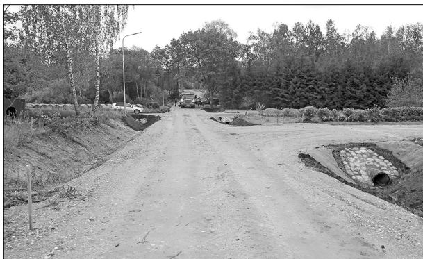
Dažādu neparedzētu apstākļu dēļ Lauku ielas pārbūves darbi Rušonas pagastā ir iekavējušies, radot neērtības iedzīvotājiem. Pašvaldība un būvnieks šobrīd ir vienojušies par situācijas risinājumu.
