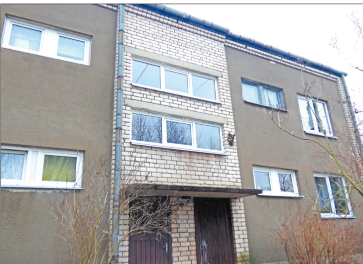
A. Upīša iela 10 kāpņu telpā uzstādīti PVC logi
