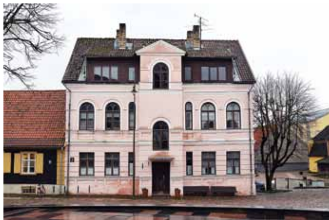
Baznīcas iela 3. Starpstāvu pārsegdes pēc ugunsgrēka jāmaina.
