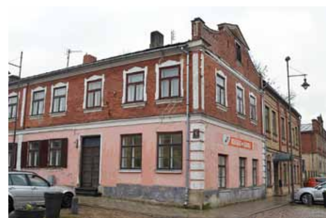
Policijas iela 1. Sienas četrās plāknēs saplaisājušas, pamati sēžas, no mājas atdalās tualetes piebūve, nelikumīgi iebūvēts logs.
