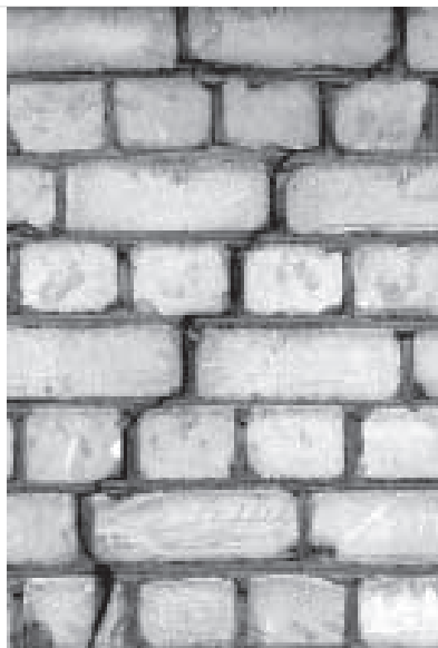
Таких трещин на фасаде немало.
