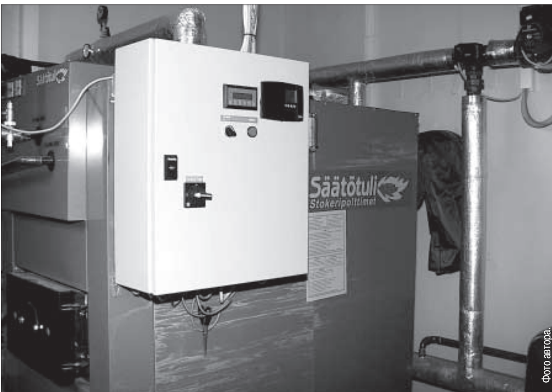
В хозяйстве В. Кведерса установлен универсальный котел, который можно топить жмыхом рапса или мелкими рапсовыми зернами, непригодными для обработки.
