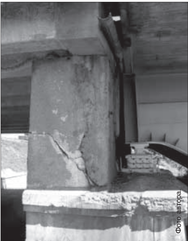
Так сейчас выглядит одна из опор моста.
