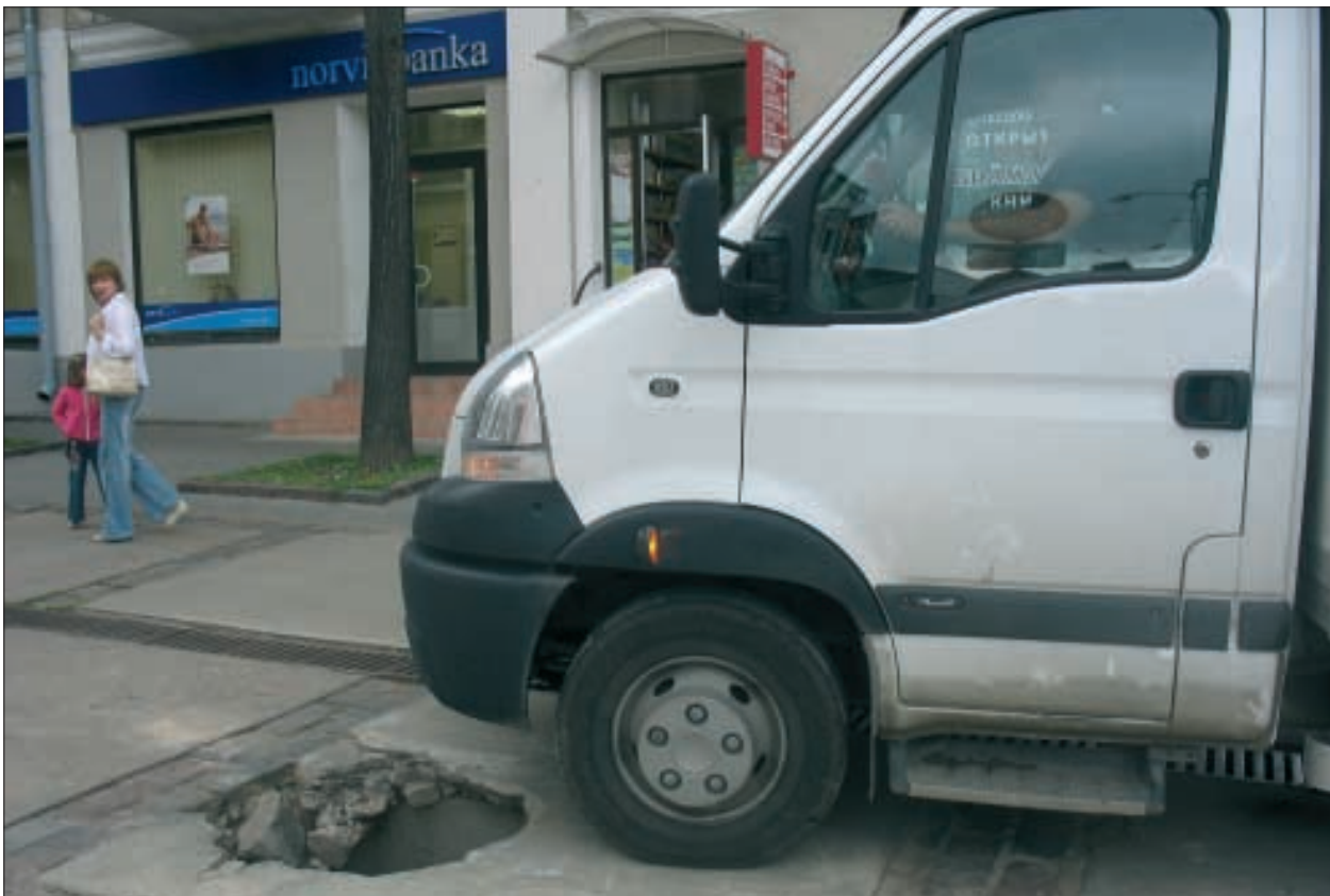
Машину остановил обвалившийся колодец.
