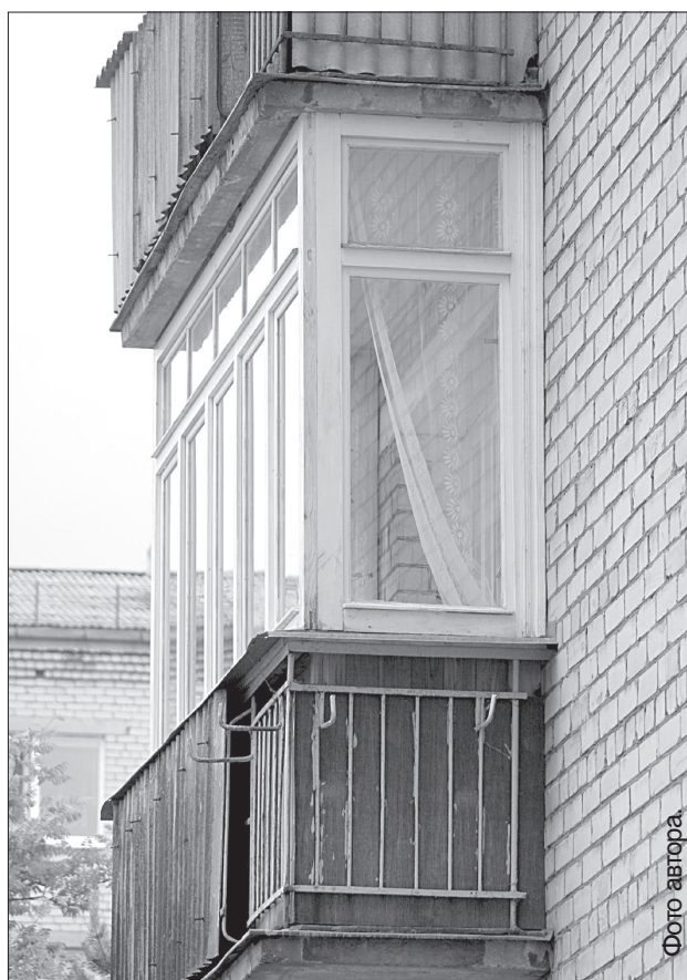
Такие конструкции запрещены.
