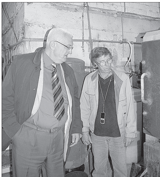
А. Айзбалтс (слева) рассказывает руководителю Лауцеского коммунального хозяйства Владимиру Морозову о ремонте отопительного котла.
