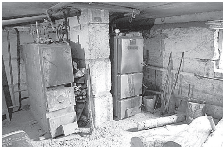
В котельной, как и во всем доме, тепло.
