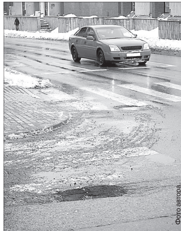
Опасная яма на перекрестке ул. Виестура и Саулес.
