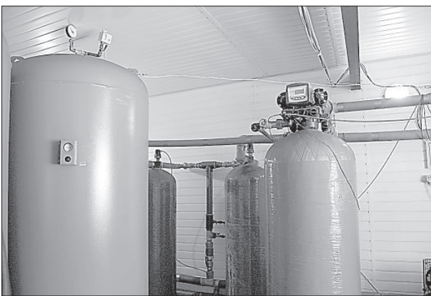
Новое оборудование водоснабжения.
