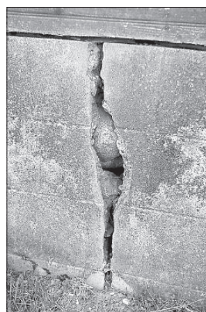
Потрескавшийся фундамент у дома А. Силовой.
