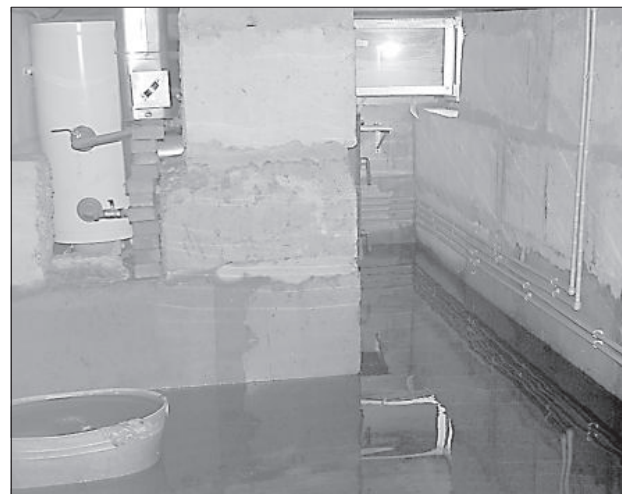
В подвале дома В. Анчупана вода повредила отопительную систему.
