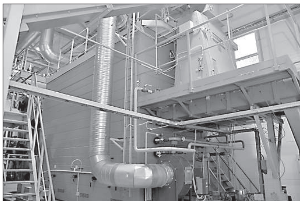
Мощность большого котла – 3 мегаватта.
