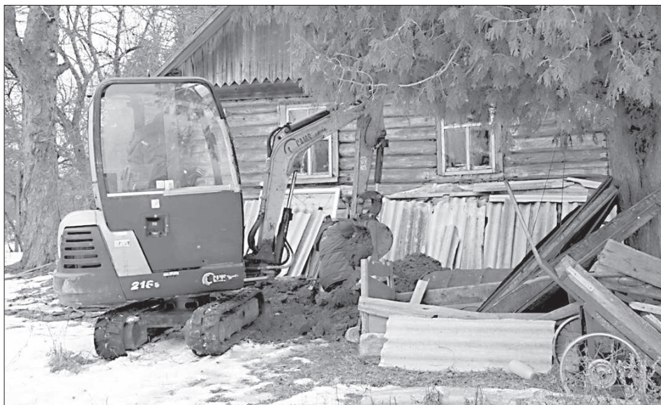
AS «Sadales tīkls» подключает электричество.
