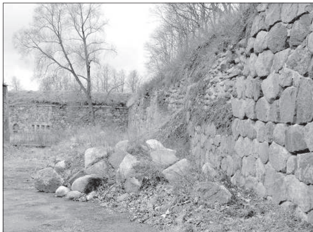
Часть стены вала обрушилась.
