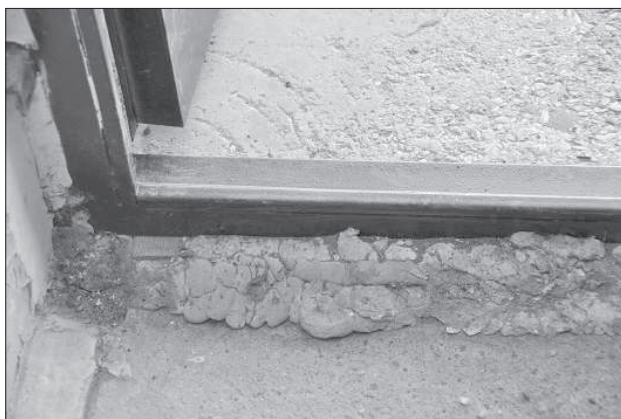
Везде видна монтажная пена.
