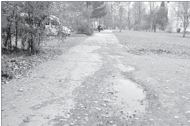
В этом году не отремонтировали ул. Сколас.
