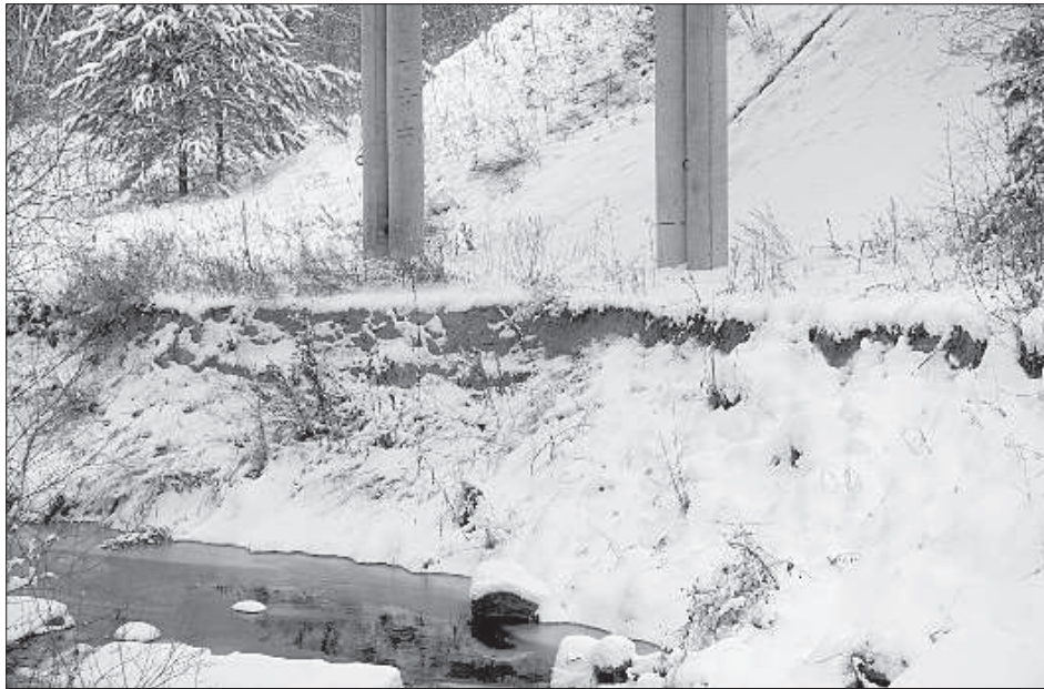
Опоры моста находятся вблизи обваливающегося берега.
