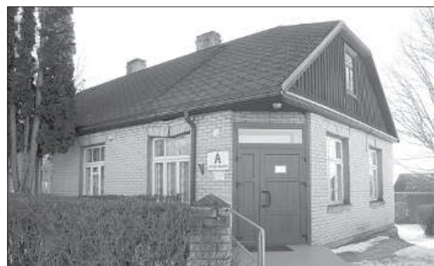
В аптеке нужно ремонтировать оконный проем и утеплять окна.
