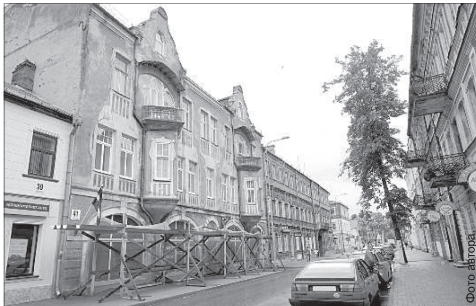
Крыша и фасад здания уже давно требовали ремонта
