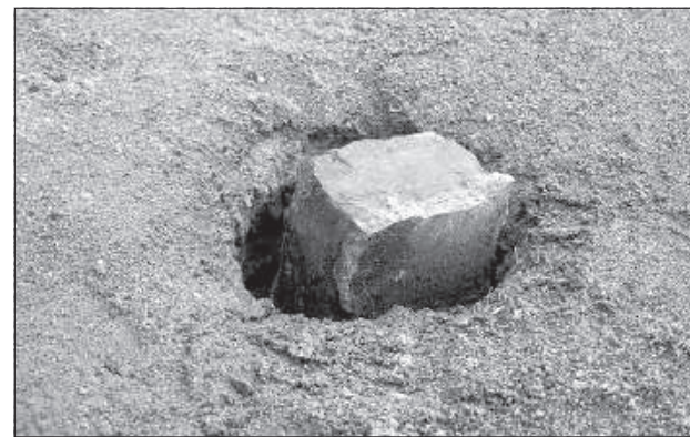
Провал ливневой канализации.
