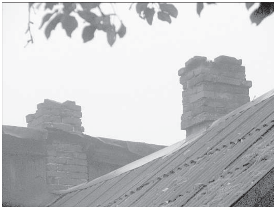
Эти трубы требуют ремонта.
