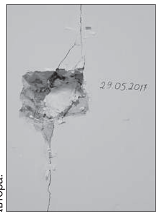
В зале трещины местами покрывают всю стену по всей высоте.
