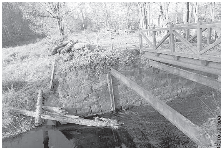
Новый мостик построен, а доски от старого моста остались.
