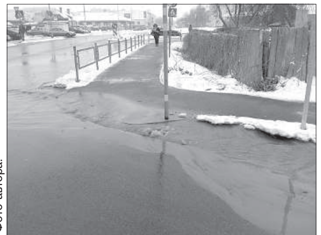
Вода «прорвала» асфальт.
