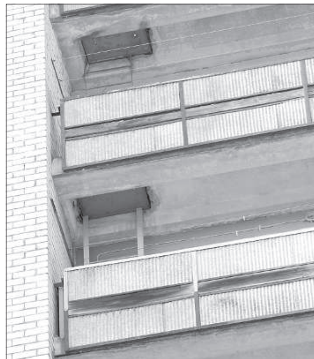
Эвакуационные лестницы на лоджиях срезаются, ключей от люков у жильцов нет.
