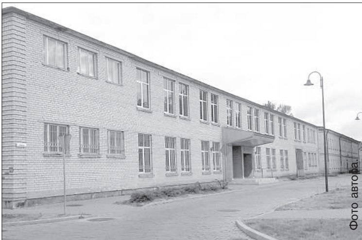
Здание архива нуждается в срочном утеплении.
