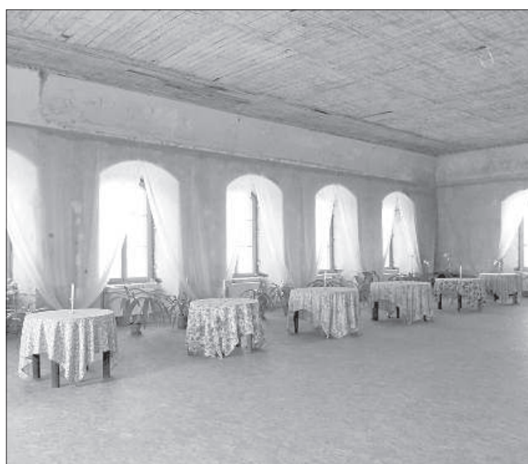
Большой зал на втором этаже уже используется для мероприятий, но нуждается в основательном ремонте.
