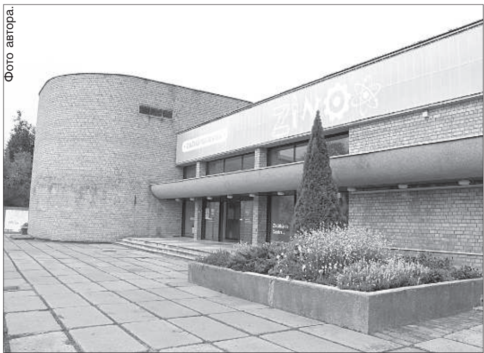
Бетонная плитка лежит перед зданием с момента постройки.
