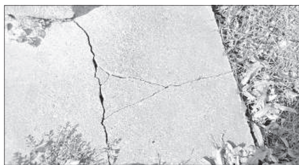
Трещины в основании дома на ул. Сатиксмес, 9.
