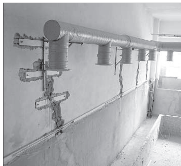
Трещины в стенах спортивного корпуса стянуты и заделаны.
