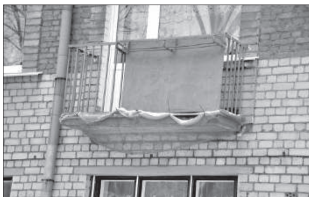
Собственники квартир в Даугавпилсе не спешат ремонтировать балконы.
